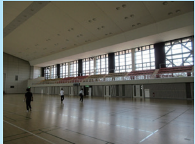
大きな空間を有する体育館の空調設備設置の例 2
