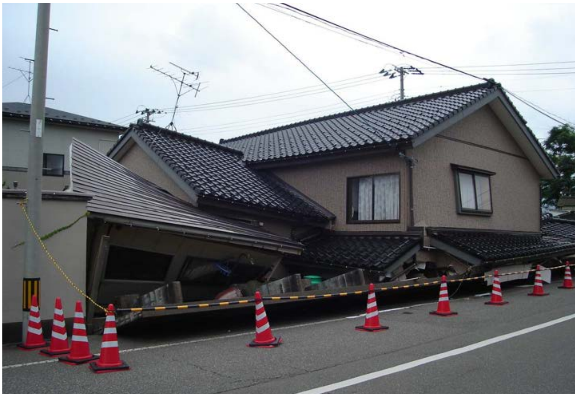
被災建築物（栄町）：見た目は新しいが、新耐震基準の住宅か
